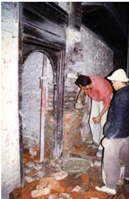
Reprise d'un angle de porte en brique, dans la maison Sennari, Le Caire, Égypte.
