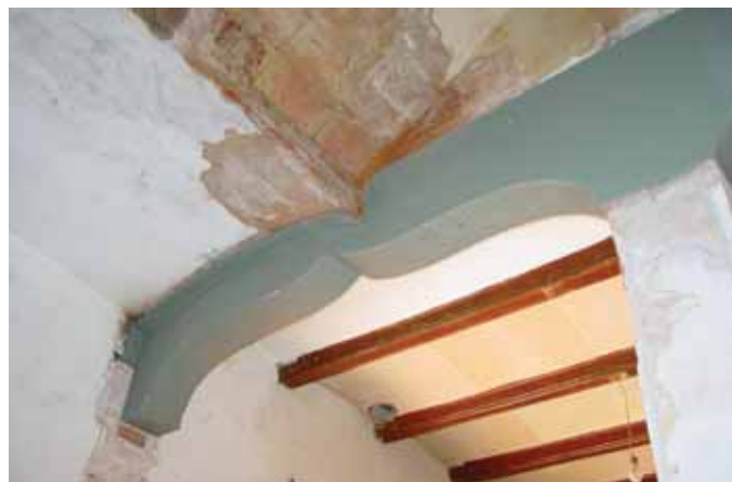
3. Renfort en tôle métallique de l'assise de la voûte d'escalier sur un arc.
