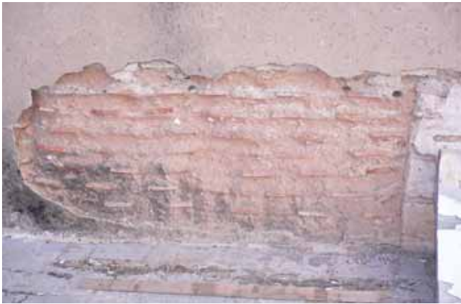
4. Mur en pisé qui a perdu son enduit protecteur faute d'entretien.
