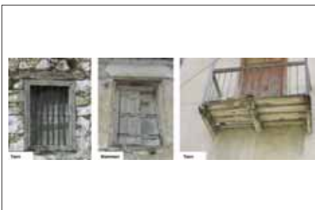
Dégradation du bois
