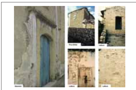
Décollement et crevasses du plâtre
