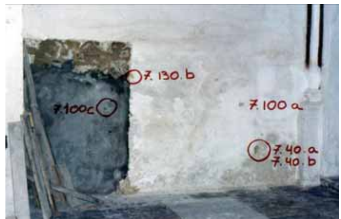
Détérioration des revêtements.
