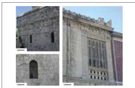
Domages causés à la pierre par la pollution de l'air
