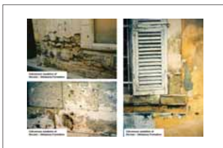
Dégradation de la pierre
