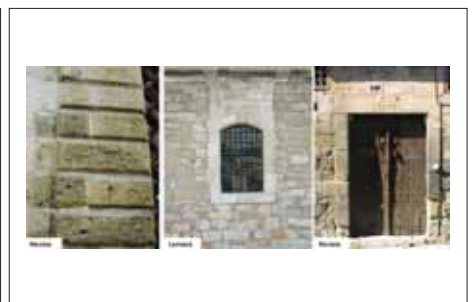
Dégradation de la pierre
