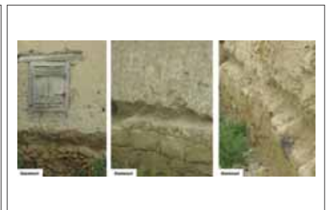
Détérioration de l'adobe dans la partie inférieure des murs
