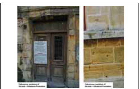
Dégradation de la pierre
