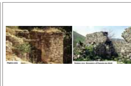
Domages causés aux murs de pierre par la végétation
