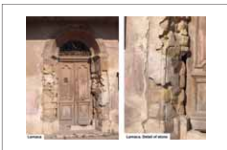
Dégradation de la pierre
