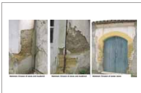
Dégradation de la pierre et de l'adobe
