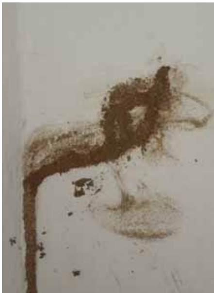
Canal de termites sur un mur plâtré
