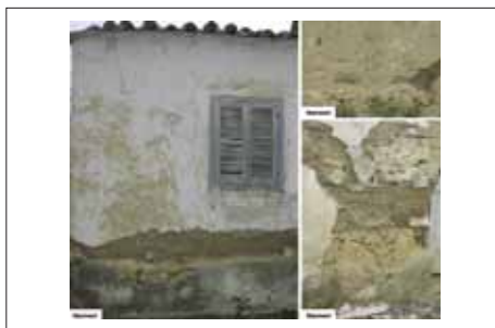
Détérioration de l'adobe dans la partie inférieure des murs
