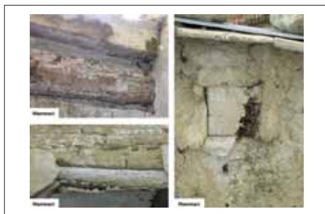
Dégradation du bois
