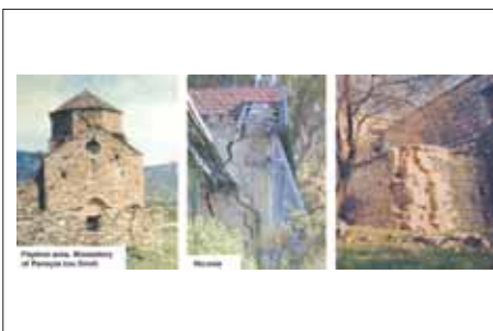
Problèmes structurels des murs de pierre
