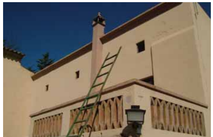
Prévision des moyens auxiliaires nécessaires pour accéder à toutes les parties du bâtiment à surveiller.
