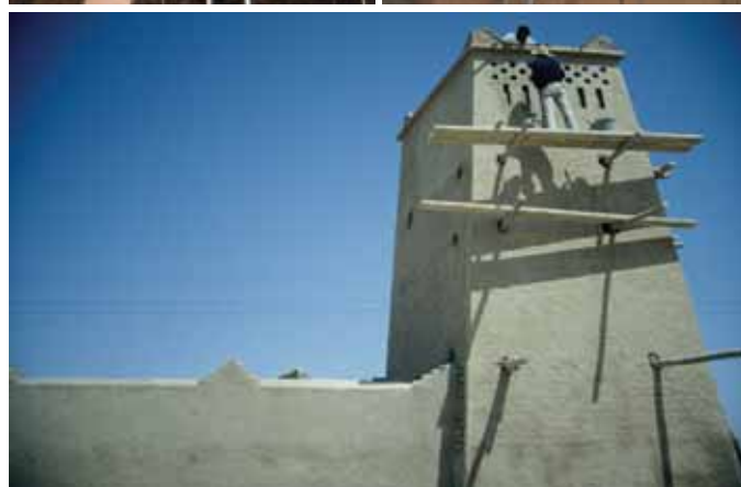
L'absence de mesures de protection adéquates implique un risque pour la sécurité des constructeurs. Quarzazate (Maroc).
