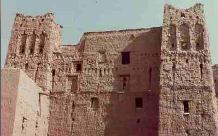
Effritement des enduits et des motifs décoratifs
